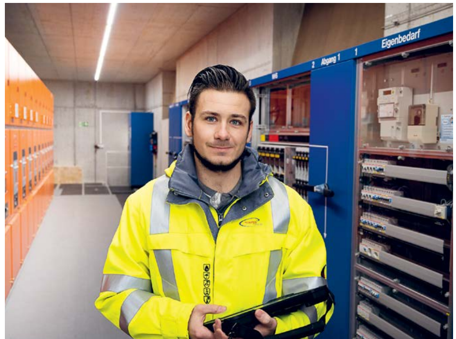
Ein derzeit hochaktuelles Projekt von Michael Honegger: der «Rollout Zählerfernauslesung» im Rahmen der Energiestrategie 2050.
